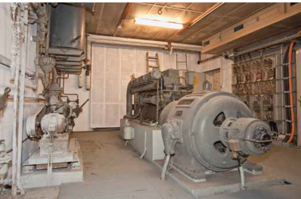
Im Untergeschoss liegt der Dieselraum. Mithilfe des Generators im Vordergrund wurde hier Strom erzeugt. Auch die Schaltkästen für die Verteilung (r.) sind noch vorhanden
